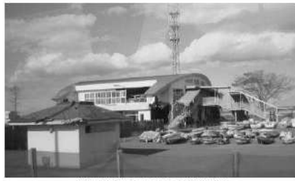
津波で被害を受けた荒浜小学校体育館
